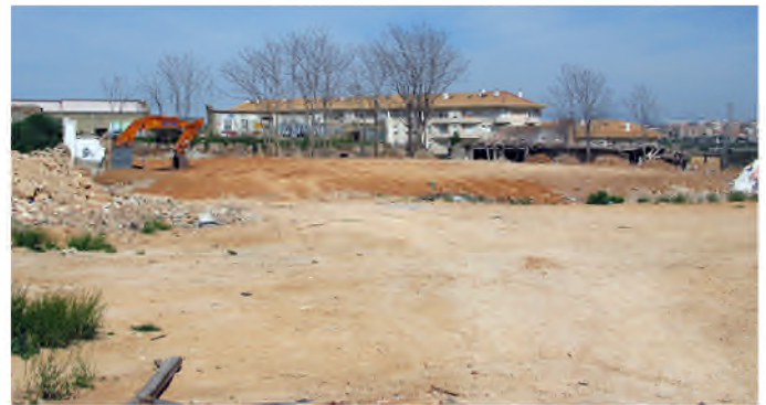
Fig. 29. Fábrica de Miramar, zona de máximo interés arqueológico. Alteración del terreno tras el derribo con el recrecimiento de más de 1 metro sobre la cota original. Fotografía del 29 de marzo de 2010.
