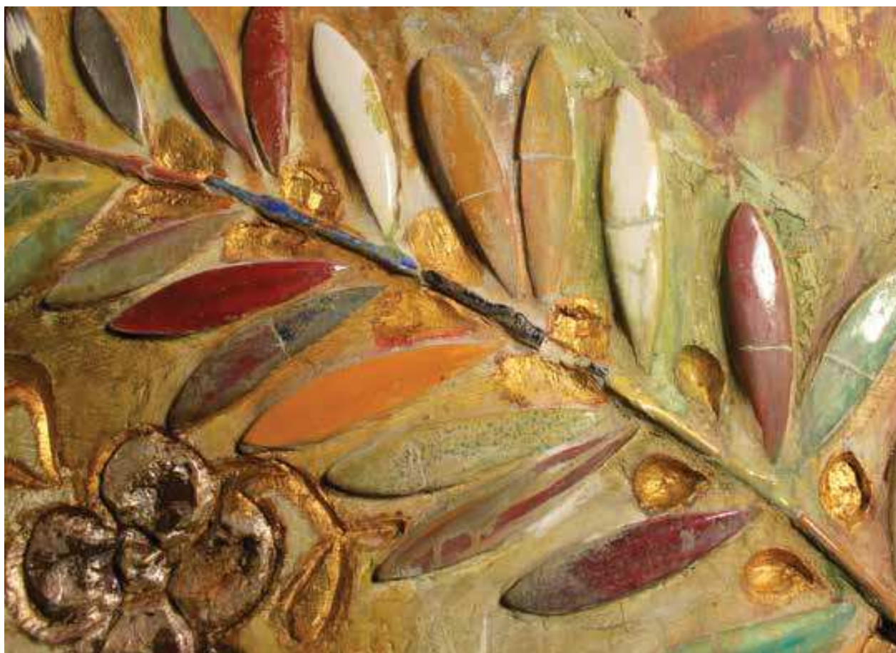
Fig. 7: Detalle de roturas producidas en el momento de la ejecución de la obra y de la aplicación de pintura sobre la decoración cerámica. Autor: Xicaranda SL (2010).
