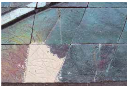
Fig. 6. En la obra de Ángel Garraza una de las piezas de la parte inferior se desprendió y se rellenó la pérdida con una pasta de cemento de color claro sin respetar los límites de la laguna.
